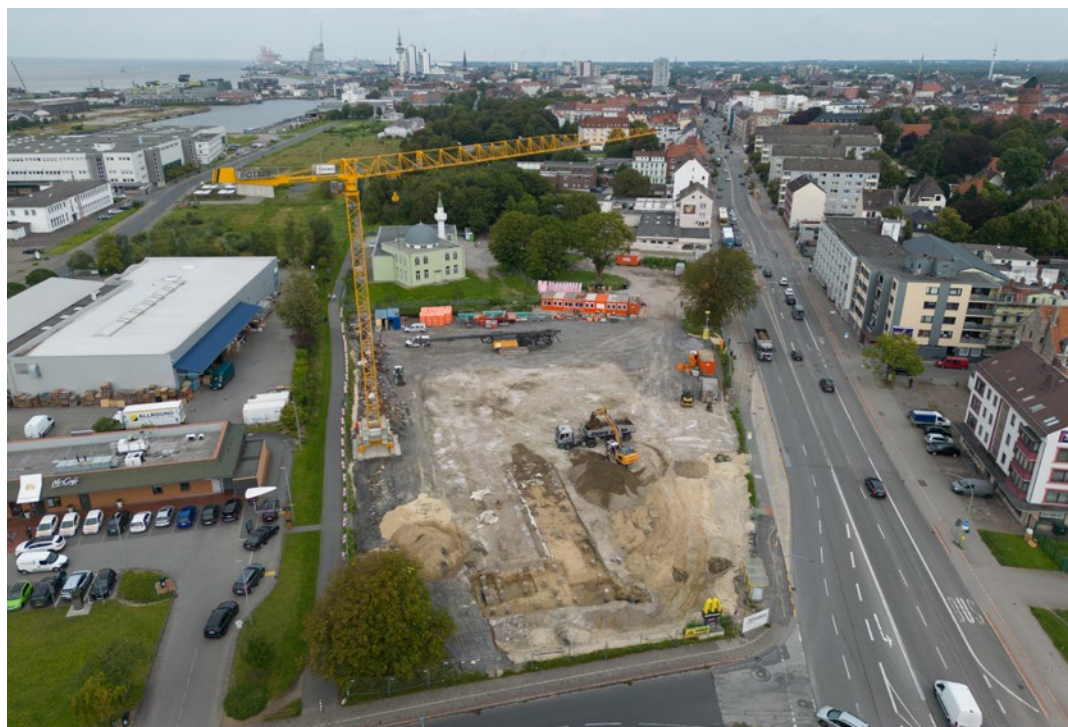
An der Georgstraße / Ecke Nansenstraße haben ebenfalls die Vorarbeiten begonnen. Am Eingangstor zum zukünftigen Werftquartier wird das neue Polizeirevier Geestemünde entstehen.
