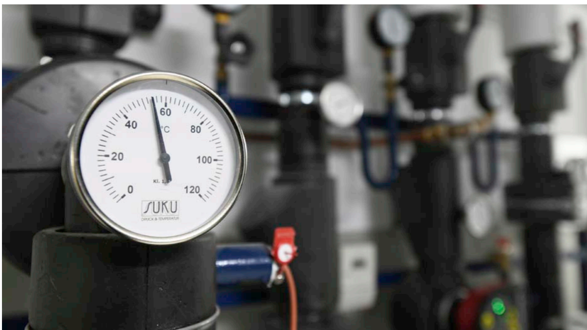
In einem Keller im Engenmoor-Quartier steht eine neue Wärmeübergabestation des örtlichen Energieversorgers.
